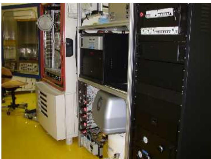
Ansicht der Anlage mit GMS und Steuereinheit
